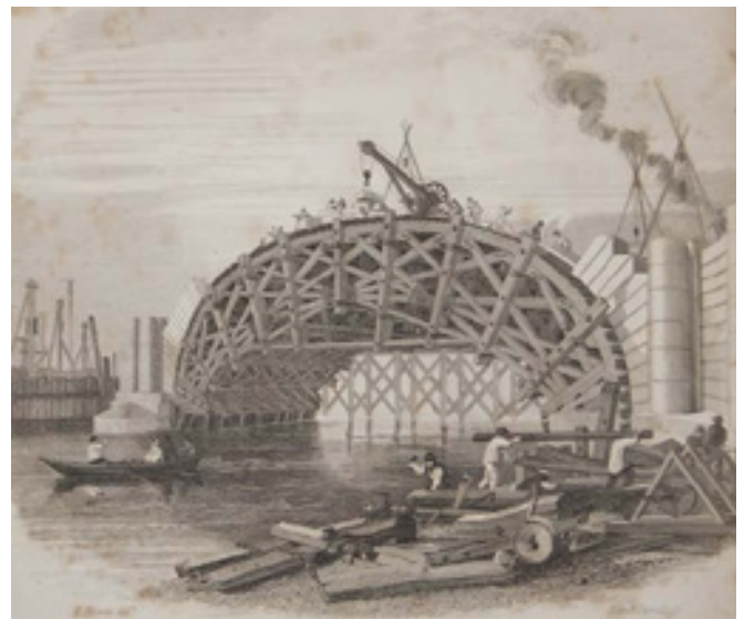
6 Ansicht der Waterloo Bridge, London, mit ihrem Lehrgerüst [Nicholson 1836, Frontispiz]. Deutlich sichtbar sind die gusseisernen Balkenschuhe an den fächerförmigen Knoten.
