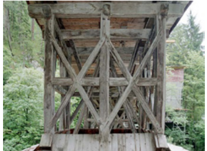
3 Fachwerkaufbau über einem Brückenpfeiler aus jeweils drei in Längs- und in Querrichtung gegeneinander verstrehten Rahmen
