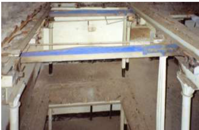
14 Castle Foregate Mill, Shrewsbury, von Charles Bage, 1796, die ersten gusseisernen Deckenbalken in Form eines »Hog-backs« mit invertiertem Y-Querschnitt
