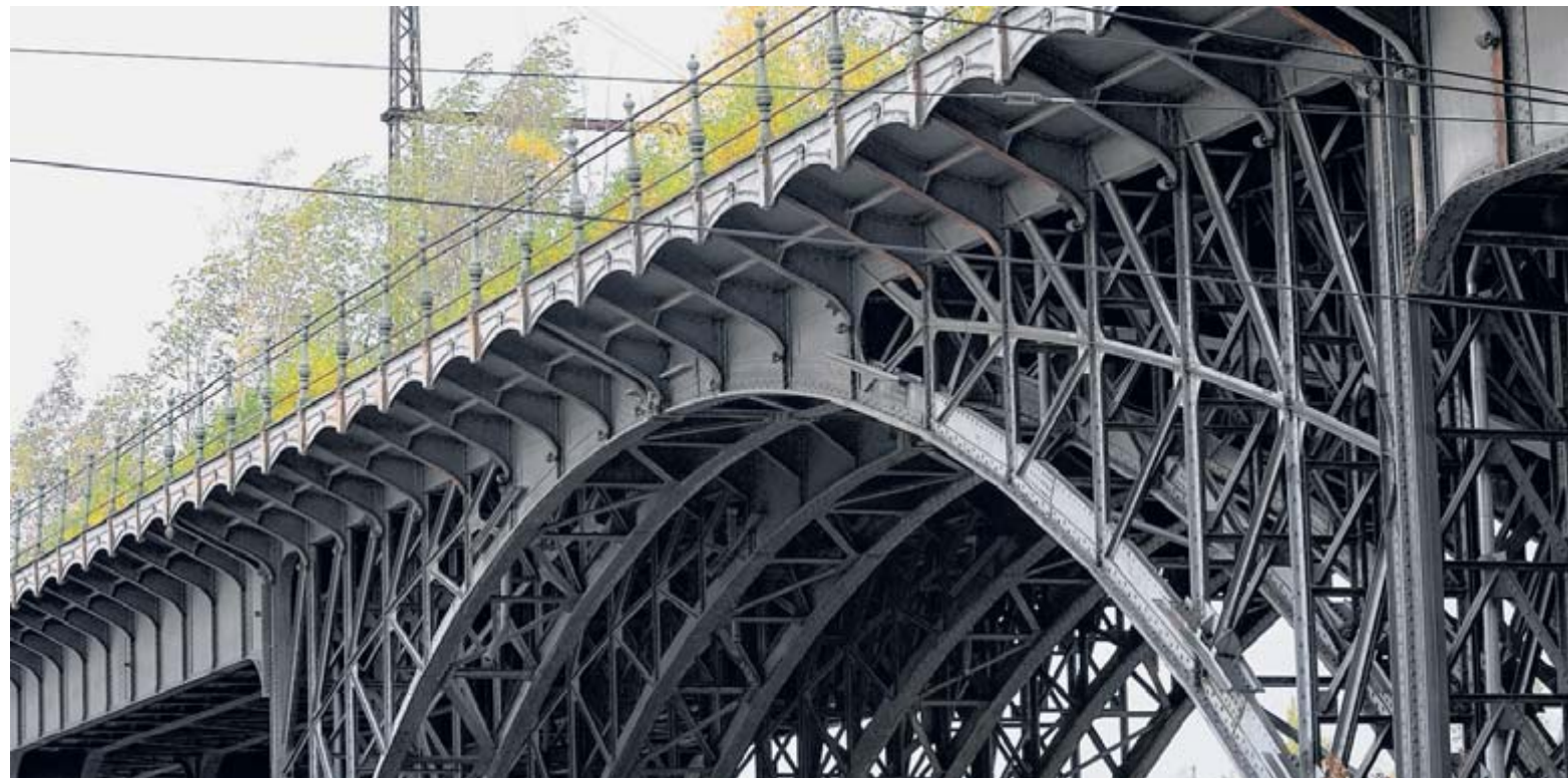
Die Verantwortlichen der DB Netz AG haben sich endgültig dafür entschieden, das Chemnitztal-Viadukt über der Annaberger Straße voraussichtlich ab 2019 abzureißen und bis 2022 durch einen Neubau zu ersetzen. Stadträte, Denkmalschützer und Bürger wollen das verhindern. FOTO: ANDREAS SEIDEL/ARCHIV
