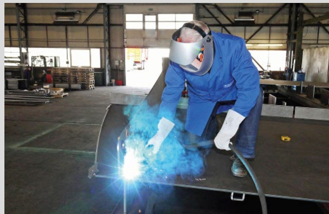
Bild 2. Die erste Schweißnaht für die Drehbrücke der Inselstadt Malchow setzte Bürgermeister Joachim Stein bei SCHORISCH Magis in Karstädt (Quelle: Schmaglowski/Inselstadt Malchow)
